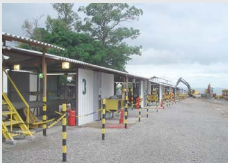
Estações de montagem dos strings
