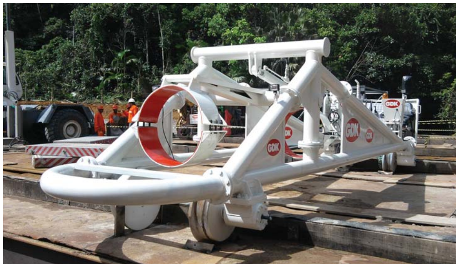
O equipamento Mad Max que será utilizado quando da realização da interligação definitiva
