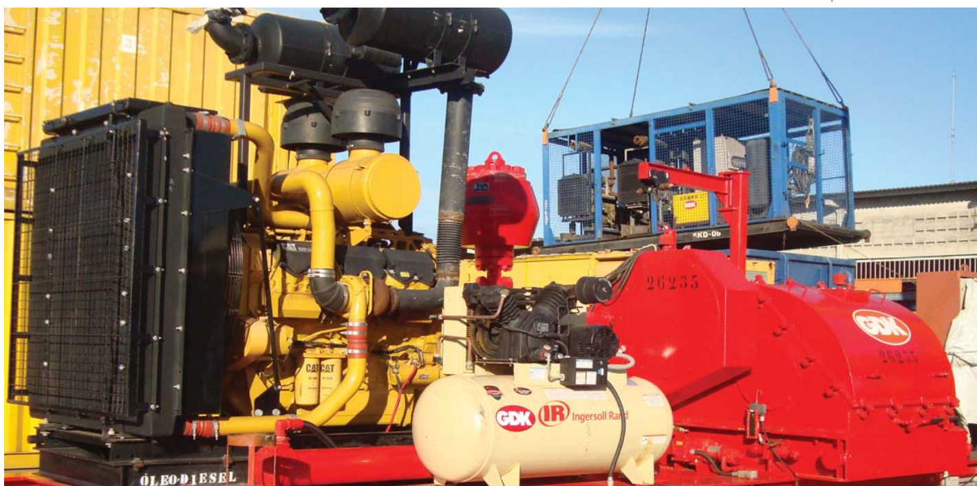
Bomba de fluido com 800HP de potência no acionamento
