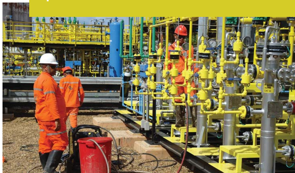
Ecomp de Coari-AM: Instalação de Turbocompressores de gás natural
